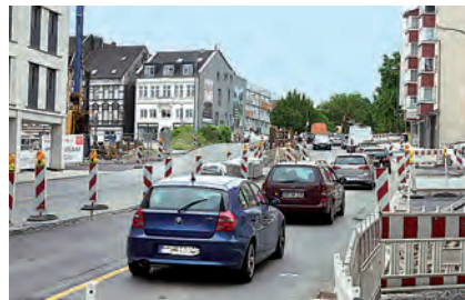
Verstopfung in der Baustelle
